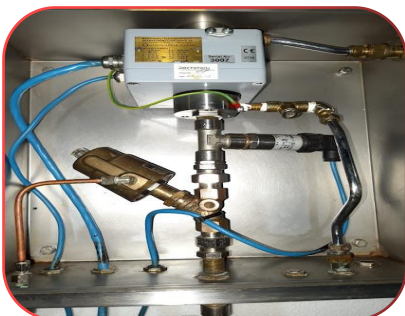
ODME Skid Unit
